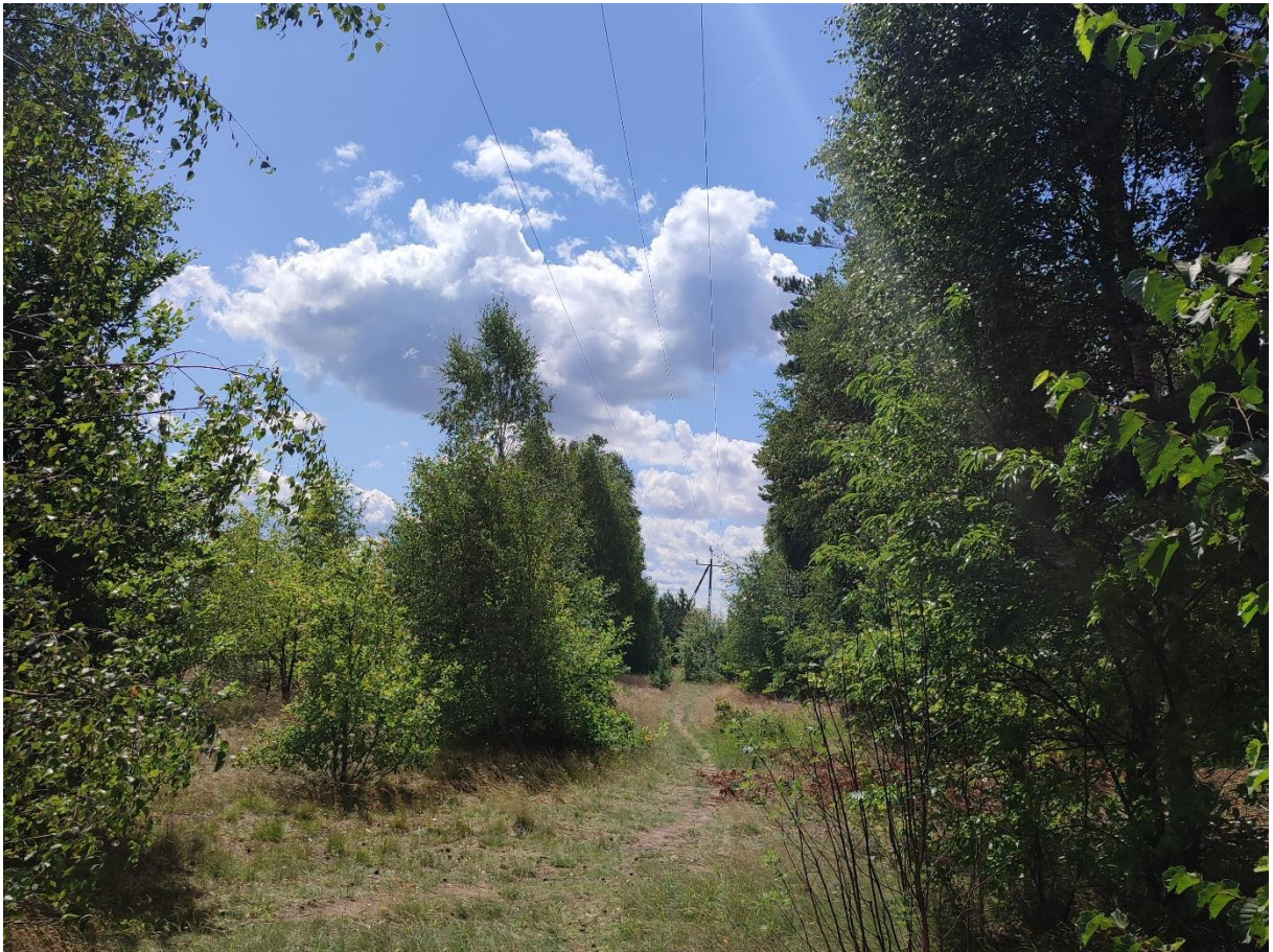
Fotografia 2. Widok na linię napowietrzną przebiegającą przez obszar oraz tereny w jej sąsiedztwie
